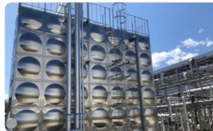
图 20: 日本那须工厂的水处理设备
