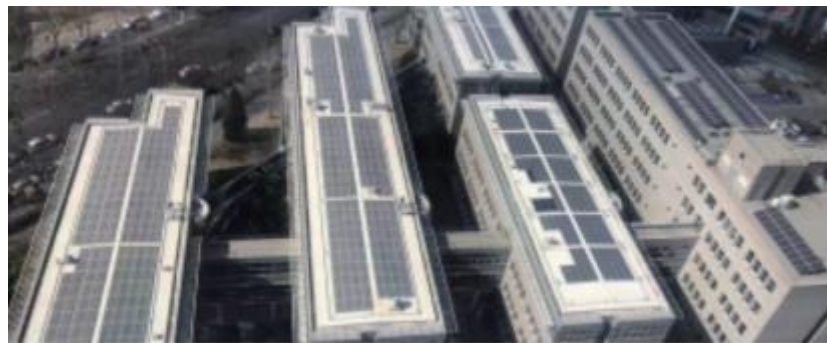
图 28：西门子园区已安装光伏设备
